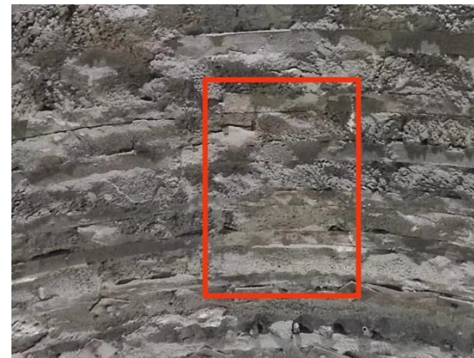
掉块区域现场图像
